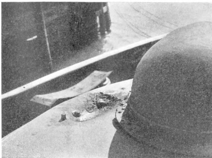
Поврежденія въ носовой башнѣ 12-сант. снарядомъ.
